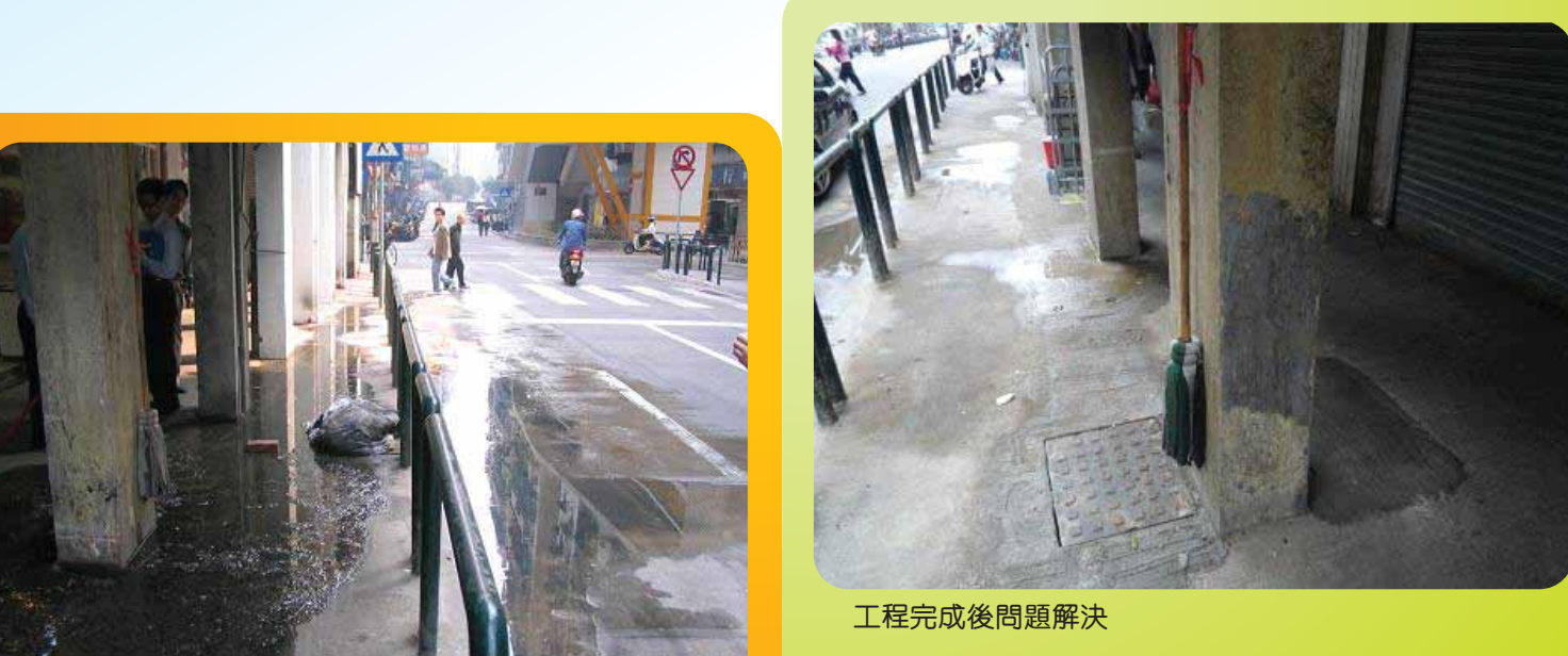
平民大廈A座公共柱廊小洞不斷湧出污水 工程完成後問題解決
